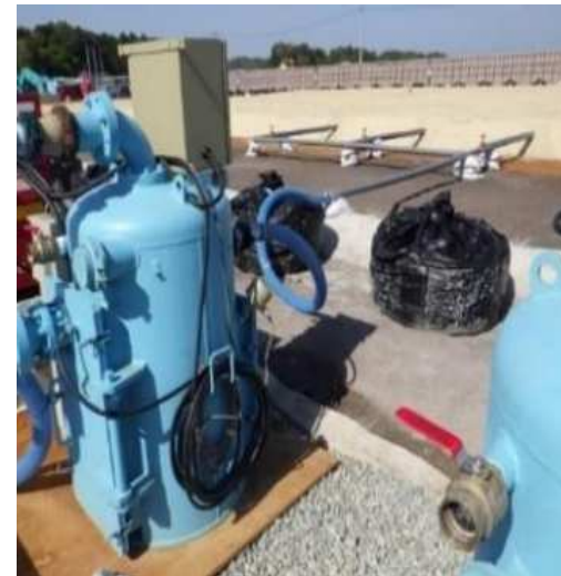
浸透水の集水設備
